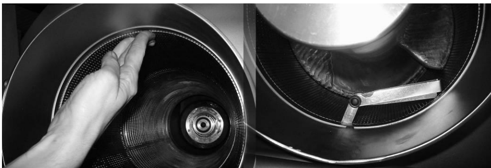
Abb.13-13: Bewegliches Sieb im Separator, Prüfung der Schwimmfähigkeit mit der Hand (links)
